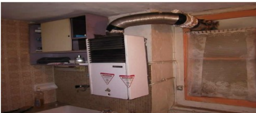
La chaudière au gaz responsable de l'intoxication était mal entretenue et installée dans une pièce mal ventilée. (photo P.H.)
