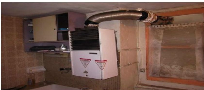
La chaudière au gaz responsable de l'intoxication était mal entretenue et installée dans une pièce mal ventilée. (photo P.H.)
